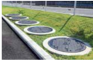
油水分離槽 工場から出る排水はこちらで油分と水に分離
